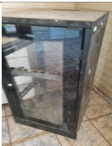
Patrimônio – 0317 Rack Servidor Triunfo de piso: Em bom estado geral, apenas marcas do tempo.
